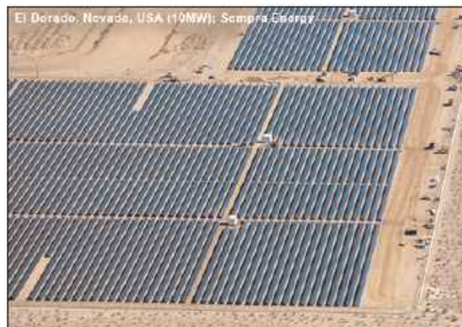
Sempra Energy's El Dorado plant.
